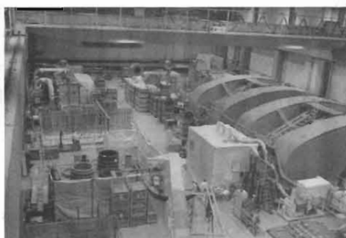
写真1 処理施設が設置されたタービンホール
